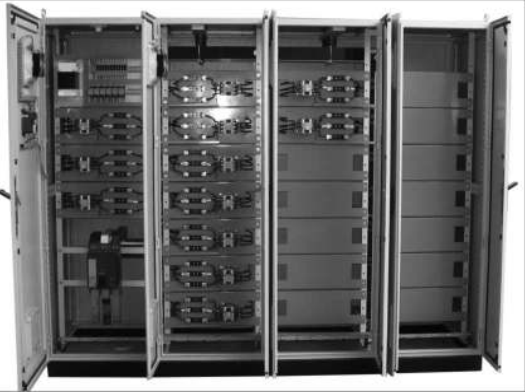
Banco de Condensadores
