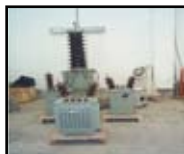
EQUIPOS DE PRUEBAS PARA TENSION APLICADA
